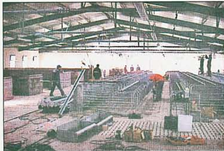
Novostavba stáje pro jalové a březí prasnice na farmě ing. Kuthana ze Suchohrdel na Znojemsku.
