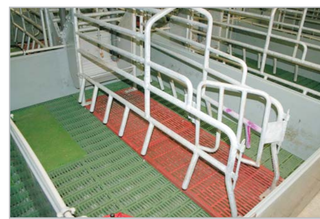
V Cizkrajově byly původní betonové podlahy nahrazeny porodními kotci Agrivan s celoroštovou podlahou: pod prasnicemi se nachází litinový rošt a pod selaty rošt plastový Foto archiv
