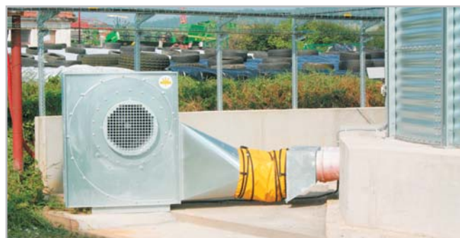
O provzdušnění se starají čtyři radiální ventilátory o výkonu 8000 m 3 vzduchu za hodinu
