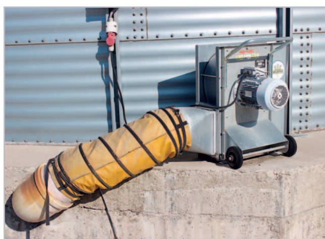
Do provzdušňovacích kanálů vhánějí vzduch středotlaké radiální ventilátory Neuro Foto Vladislav Fuka
