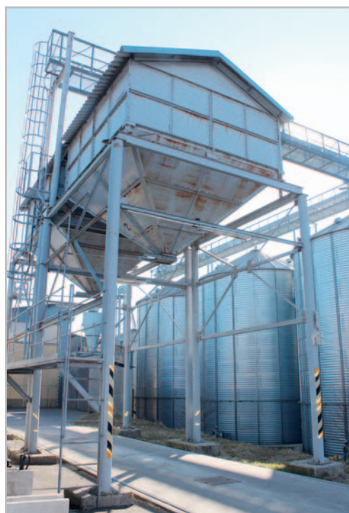
Dva podjezdové zásobníky na 2 x 30 tun s mostovou váhou. Všechny cesty v posklizňové lince jsou průjezdné Foto Vladislav Fuka
