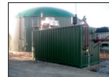
Bloková elektrárna v kontejneru
