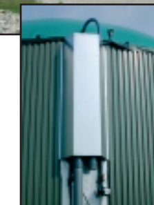
Technologická šachta - nerez
