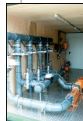
Čerpací technika v kontejnerovém provedení
