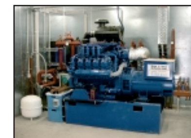
Bloková elektrárna zevniť
