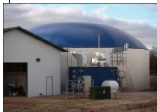
Fermentor s kontejnerovou blokovou elektrárnou
