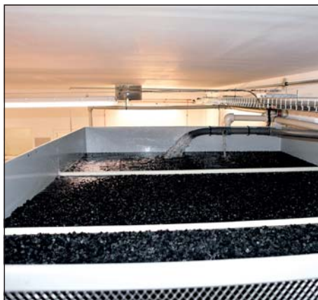
Bioszűrő a szűrőfelületet megnövelő elemekkel
